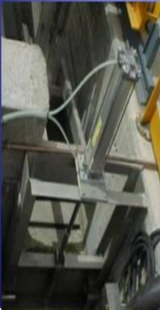
Stavila de canal
